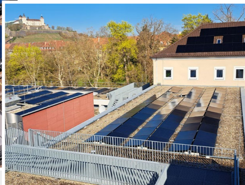
Photovoltaik Anlage auf dem Studentenhaus in Würzburg
